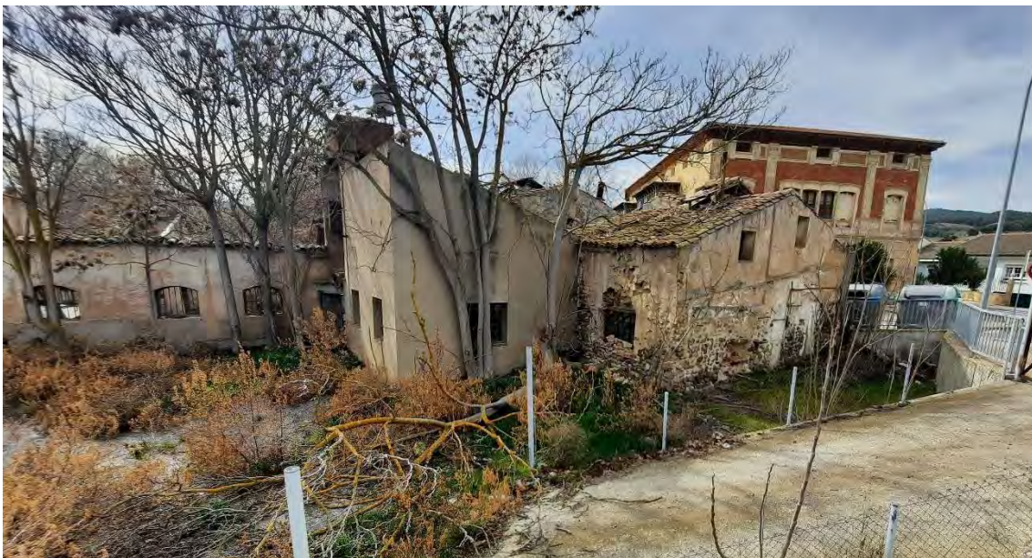
En primer término edificaciones de la parcela 1315. Algunas de ellas han sido derribadas.
