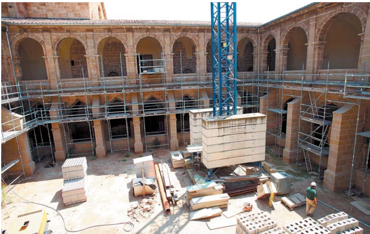
Una imagen del claustro del monasterio durante los trabajos que se realizaron en la séptima fase de su rehabilitación.
