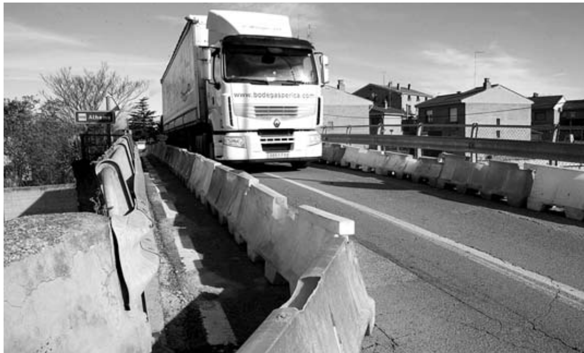
Un camión pasa por el puente de Fitero en el que el Gobierno ha limitado el paso por daños estructurales. N.G.L.
